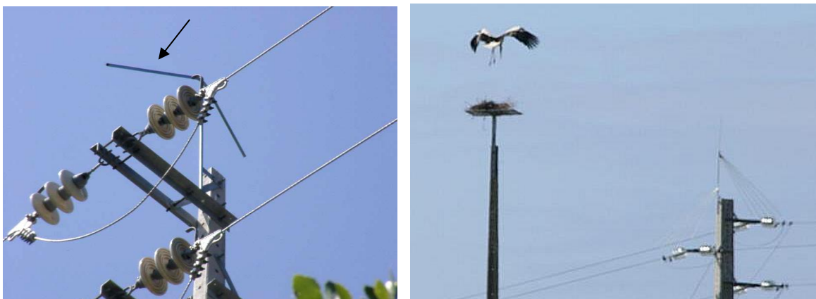
Figura 11. Postes de distribución con ángulos asimétricos en la parte superior (véase flecha) y placas metálicas como dispositivo para desalentar a las aves (Foto: DP-Distribution, Portugal;), y poste de distribución con pinchos de exclusión de aves y un poste diseñado para la anidación para la Cigüeña blanca en las cercanías. (Foto: Carlos Tiago).
