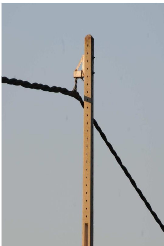
Figura 9. Cable de media tensión totalmente aislado en España suspendido de un poste de cemento sin necesidad de aislantes (Fuente: Haas, 2011).
