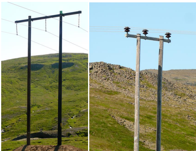
Figura 4. Izquierda: una línea horizontal de bajo voltaje segura con tres conductores suspendidos debajo de la cruceta con aislantes lo suficientemente largos. Derecha: una línea de bajo voltaje en Islandia peligrosa para grandes aves zancudas, como el Chorlo Trinador ( Numenius phaeopus ) y el Aguja Colinegra ( Limosa limosa islándica ), y para grandes aves de presa (en este caso el Pigargo Europeo ( Haliaeetus albicilla ) y el Halcón Gerifalte ( Falco rusticolus )) por los conductores adjuntados a aislantes cortos en la parte superior de las crucetas. En este caso, la modificación podría incluir aislar el cable conductor central y/o cubrir los aislantes (Foto: Bureau Waardenburg).
