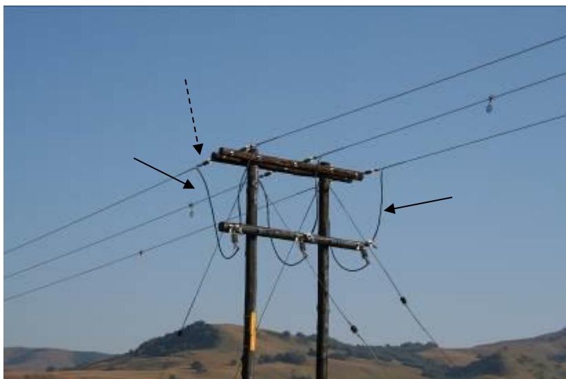
Figura 8. Una estructura de postes consecutivos segura con cables de puente aislados (flechas negras) y aislantes lo suficientemente largos (flecha rota) (Foto: EWT-WEP).
