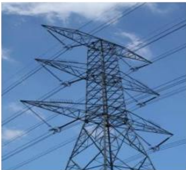
Figura 18. Una configuración de cable vertical con cables en cuatro niveles (conductores trifásicos y un cable de tierra). Comparar con las cifras de arriba, donde la configuración horizontal resulta en cables de sólo dos niveles. La disposición vertical multi-nivel es más peligrosa para las aves, porque supone un obstáculo en un plano mayor (foto: EWT-WEP).
